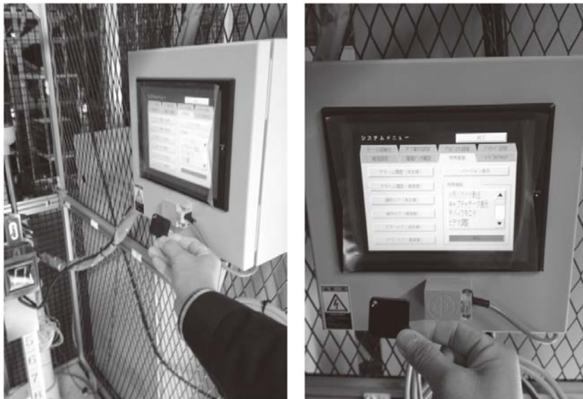
図2 入退出ゲートと作業者 ID 識別装置
