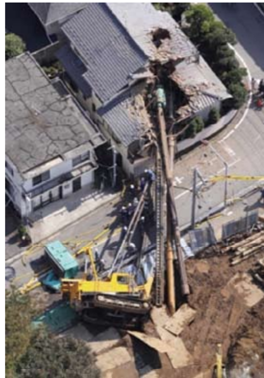
くい打ち機の転倒事故
