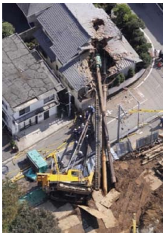
くい打ち機の転倒事故
