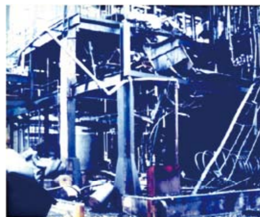
異常な反応によって破壊した化学設備
