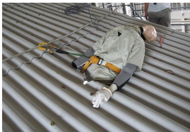
親綱・安全帯の使用例 (スレートを踏み抜いた場合も墜落を防止できる)
