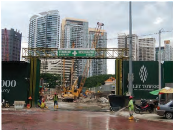
写真3 クアラルンプール中心部の工事現場 マレーシア語で UTAMAKAN KESELAMATAN (安全第一)の表示が目立つ
