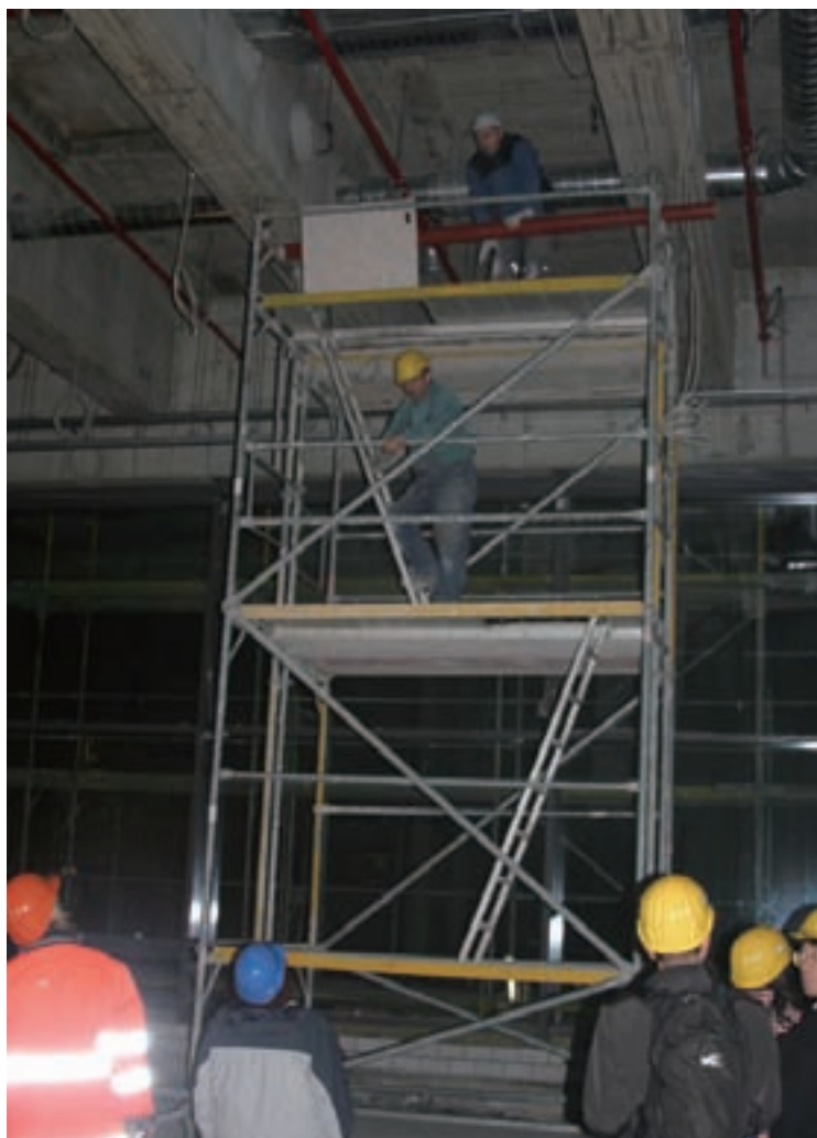
写真 3 青い保護帽の女性（労働保護・健康管理・安全技術局の職員）と、赤い服の女性（BAU の職員）による臨検の様子を撮影したものである。ここでは、 ①作業場の照明設備の不備（照度不足） ②ローリングタワーの最上段の手すりの不備が指摘され、即時の改善命令が出された。
