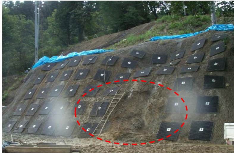
図 3.18 崩壊箇所全景
