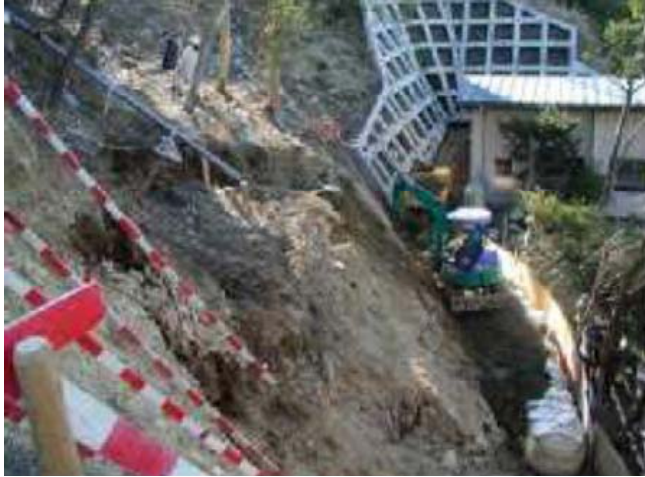
図 3.15 崩壊箇所全景
