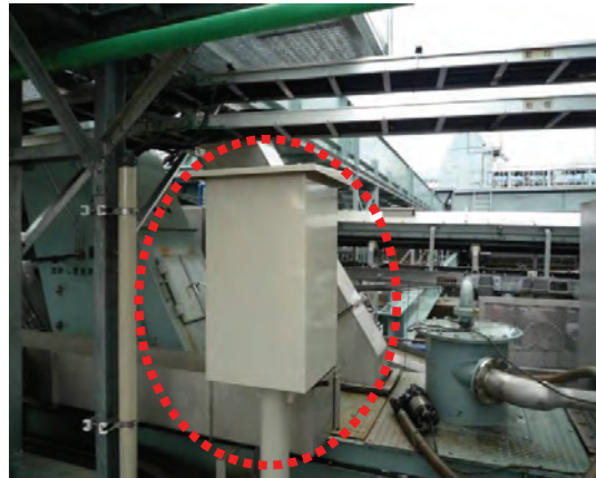
●操作盤の高さを変更した。
