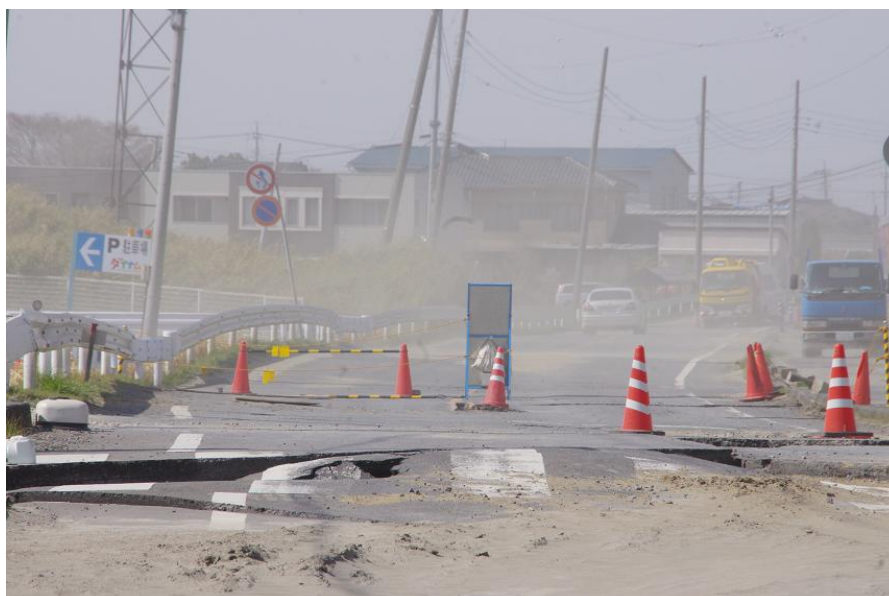
東日本大震災（土質リサーチ 大里重人氏提供）
