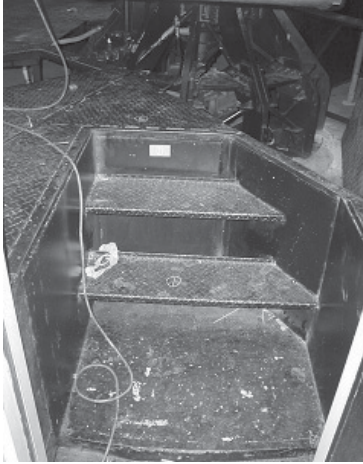
Photo 4 Entrance and exit door. 遠心ピット内入口
