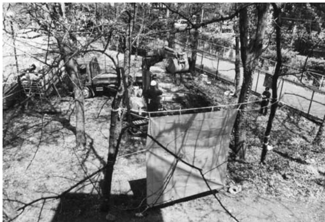
Photo.1 The excavation site of experiment executed 実験が行われた掘削作業現場
