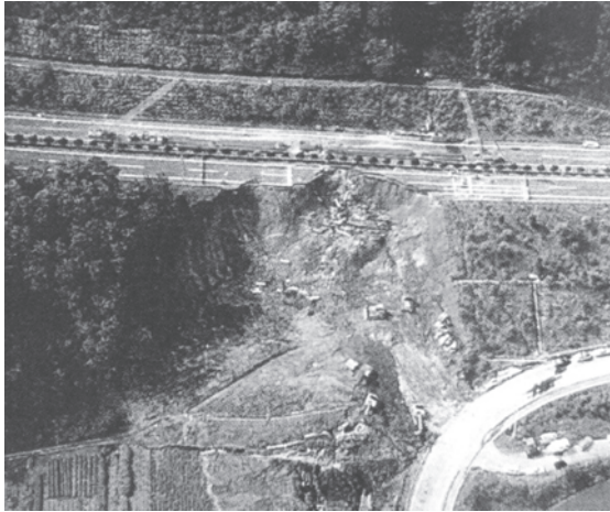
Photo 2 Slope failure in embankment of road. 高速道路盛土の崩壊事例
