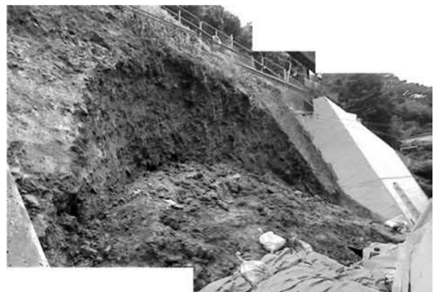
Fig. 2 Typical examples of slope failure. 建設工事中の斜面崩壊による労働災害事例 14)
