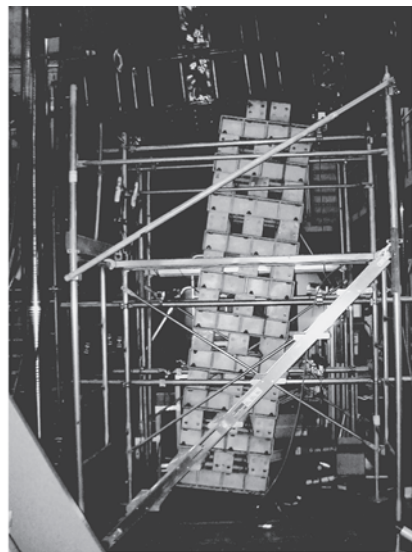
写真6 サンドルの横倒れ
