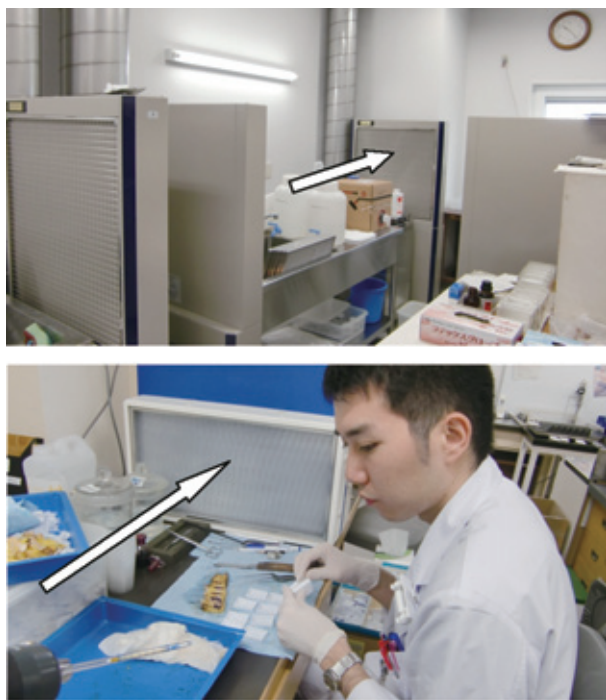
図5.ばく露低減対策として導入された開放式プッシュプル型換気装置(上:切り出し室内に導入された大型の換気装置,下:卓上型の換気装置)
