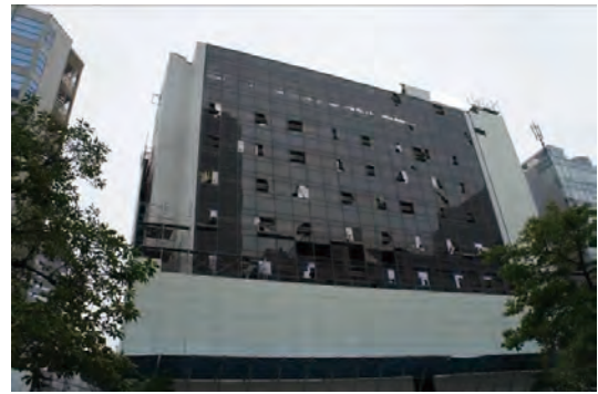
図2 足場が倒壊した解体中の建物（事例1）
