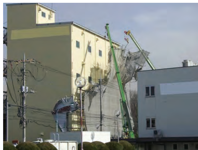
図 1 台風等の強風により倒壊しそうな足場の例
