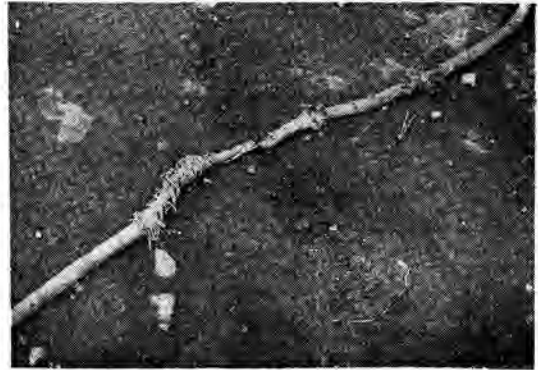
回 10 溶接回路用ケーブルの被覆の損傷したものは感電の危険があるためテーピングして絶縁しておかなければならない。
