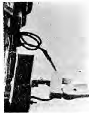
図 6 (b) 低圧全閉開閉器 (開放状態)
