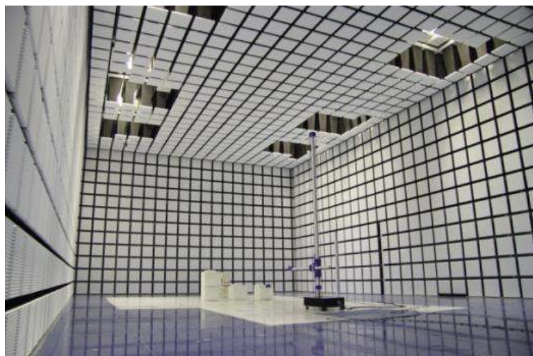
10m法対応電波暗室
