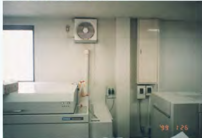
全体換気装置
