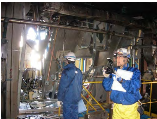
図 3 工場内部の損傷状況
