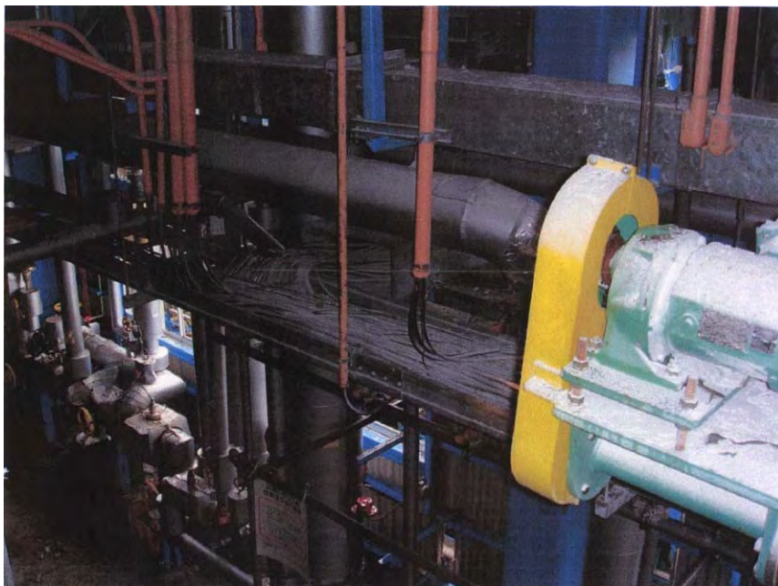
図 5 C 工場のミキサー横上部における粉じんの堆積状況
