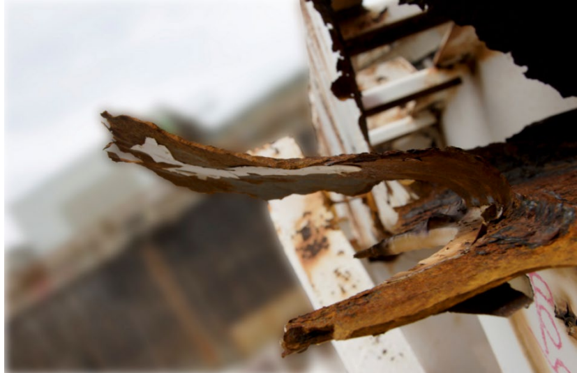
写真1 破損箇所の拡大写真
