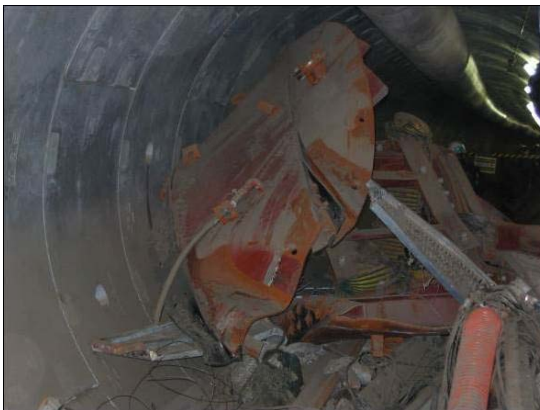
写真1 破壊した隔壁の状況
