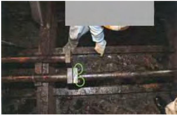
写真4 油圧配管を右舷方向に見たところ画面上側（船尾方向左側）の配管は既に取り外したもので、床にボルトが落ちている
